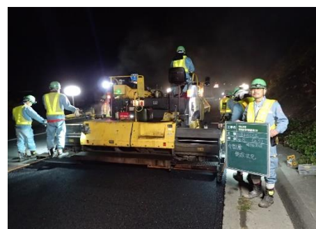
写真-2 時ヶ谷地区状況
