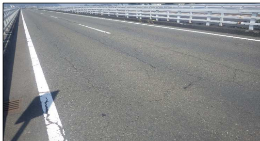
写真-1 既設路面損傷状況
