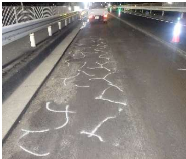
写真-7 クラック発生状況
